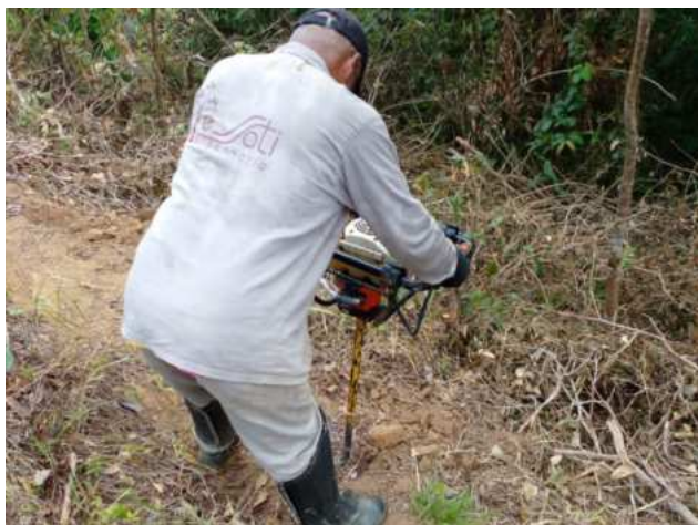
Figura 19 - Coveamento no setor M.2.1
