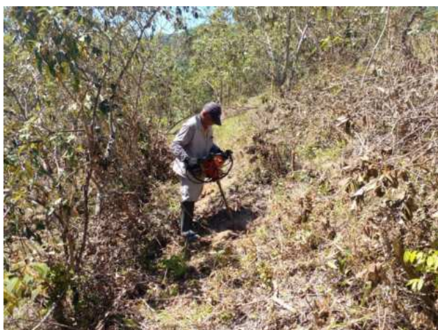
Figura 23 - Coveamento no setor M.2.1
