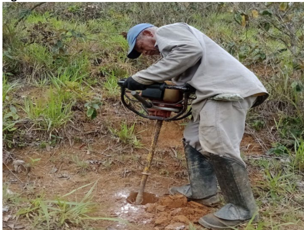
Figura 11 - Coveamento no setor M.2.2.
