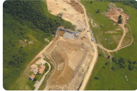
Foto 2 – Aterro Sanitário Dois Arcos, em São Pedro da Aldeia, em 2010. Hoje o aterro conta com uma Usina de Tratamento de Biogás. Fonte: Dois Arcos
