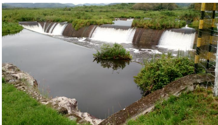
Figura 43: Vista do ponto 15 (28/1/16) e acúmulo de macrófitas.
