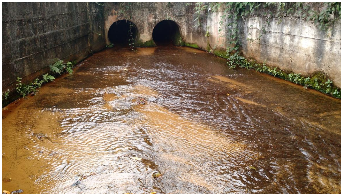
Figura 04: Imagem do rio Indaiçú canalizado no ponto 09 (Indaiaçu - Montante).
